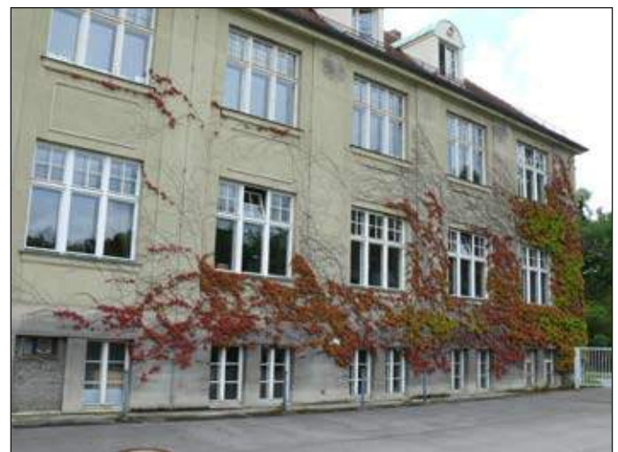
Abb. 8b: 3.8.2012: Westlicher Flügel der Nordfassade des Botanischen Institutes mit teilweise abgestorbenem und vorzeitig rot gefärbtem Wilden Wein. Auf die Nordfassade treffen aus ca. 150 m Entfernung Hochfrequenzmissionen ausgehend von den Mobilfunksendeanlagen des Eichamtes auf. Die Hochfrequenzmessung ergab 4.980 \mu\text{W}/\text{m}^2 (Foto: C. Waldmann-Selsam).
