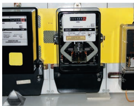
Herkömmlicher, harmonisierter Analogzähler – Ferraris Zähler
